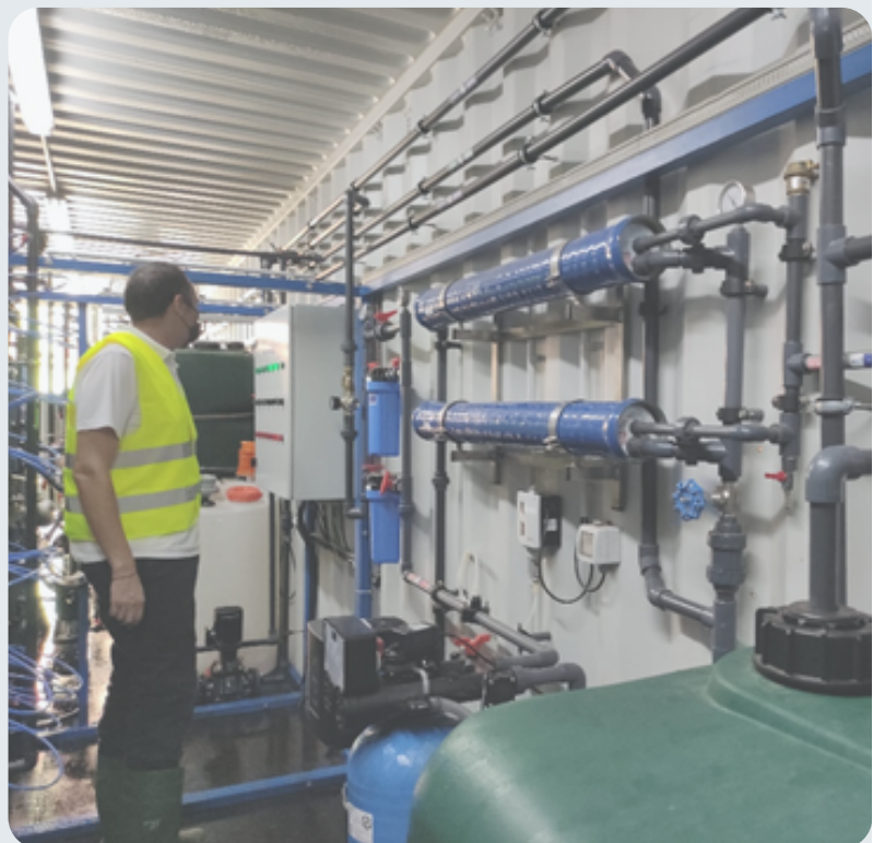
Instalación piloto con tecnología de electromembranas
