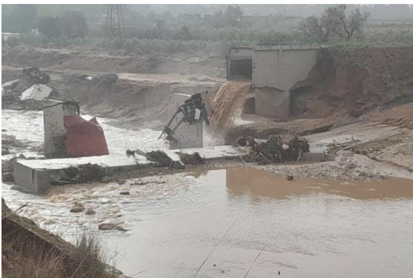
Figura 1. Rotura del Canal Júcar-Turía a su paso por el barranco de Horteta
